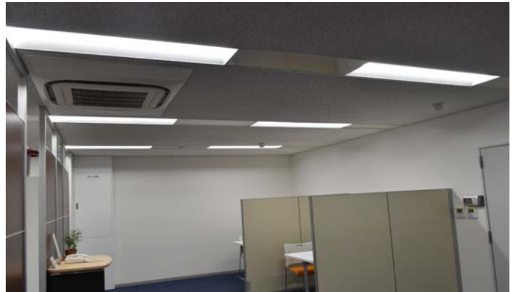
○本社3階事務所内ブースLED化状況
