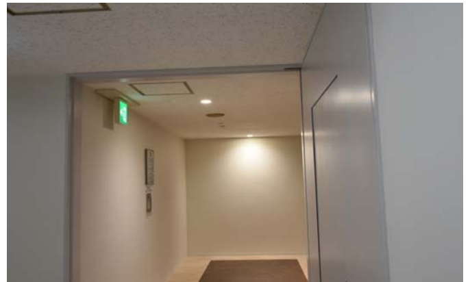
○本社3階4階エレベーターホールLED化状況
