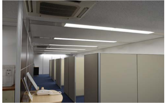
○本社4階事務所内ブースLED化状況
